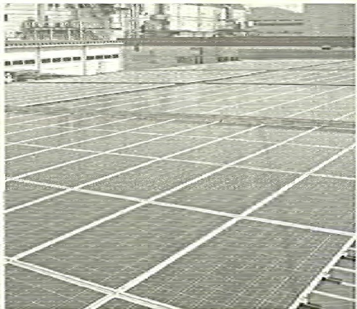
接着剤で設置された太陽電池モジュール。工期の短縮が見込め、雨漏りへの心配も不要。
